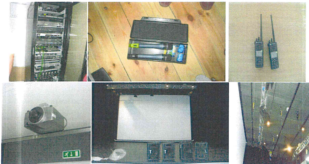
Zdjęcia 15 – 20 Część urządzeń zamontowanych w budynku, szafa z urządzeniami sterującymi, mikrofony (2 szt.), radiotelefony (2 szt.), projektor multimedialny, ekran multimedialny, głośniki, oświetlenie sceny.
